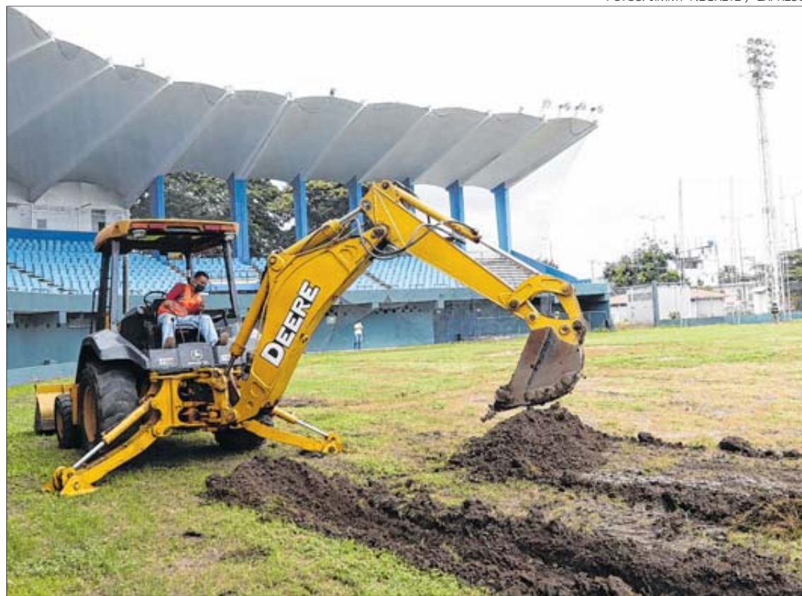
Trabajo. Los operarios de la maquinaria pesada empezaron ayer las labores de remoción de tierra para mejorar el drenaje del Yeyo.
